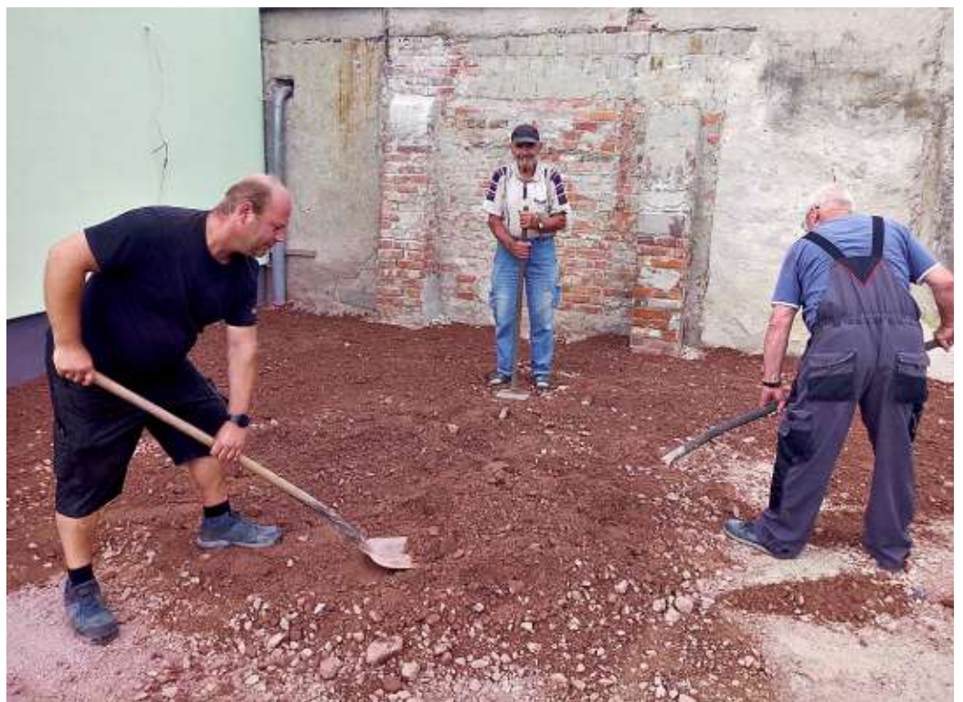
Denny Zahn (von links), Martin Hinze und Jörg Krökelmeier bei den Arbeiten am Dorfgemeinschaftshaus in Bottmersdorf Foto: Christian Besecke
