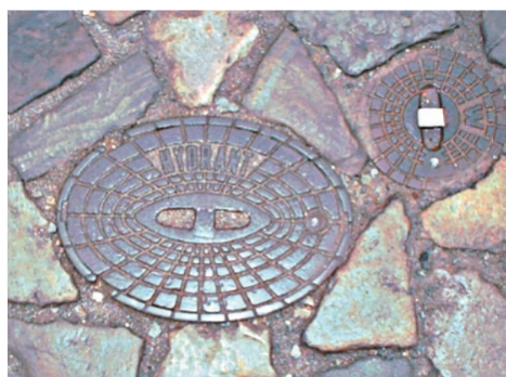
Unterflurhydrant (ovaler Deckel mit Aufschrift Hydrant )
