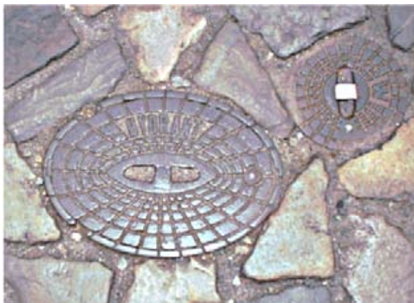
Unterflurhydrant (ovaler Deckel mit Aufschrift Hydrant )
