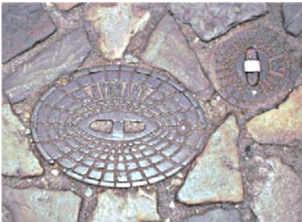
Unterflurhydrant (ovaler Deckel mit Aufschrift Hydrant )
