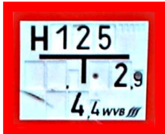
Hinweisschilder zum Auffinden von Hydranten
