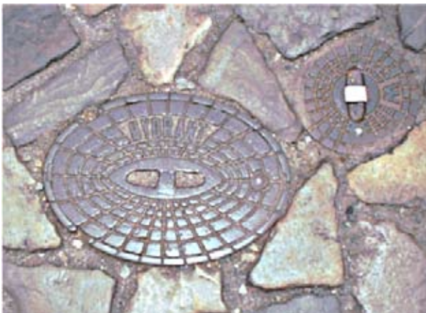
Unterflurhydrant (ovaler Deckel mit Aufschrift Hydrant )
