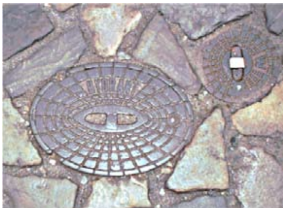
Unterflurhydrant (ovaler Deckel mit Aufschrift Hydrant )
